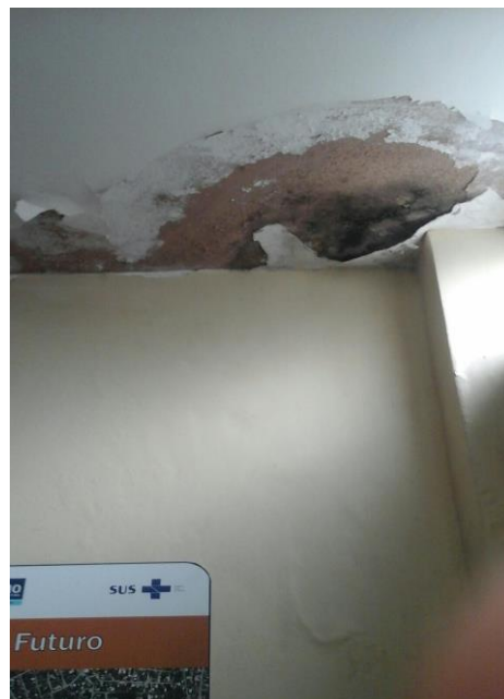
Teto com infiltração na farmácia
