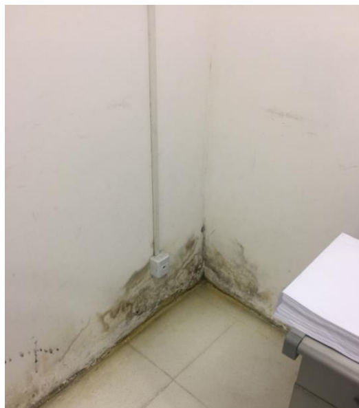
Paredes com infiltração (Deolindo Couto)
