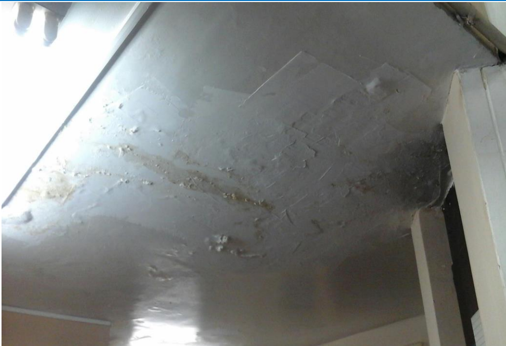
Teto com infiltração próximo à sala de esterilização – CMS Milton F. Magarão
