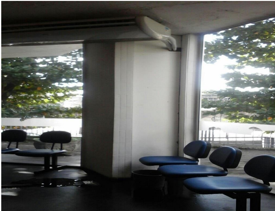
Ar-condicionado apresentando vazamento-CMS Milton F. Magarão
