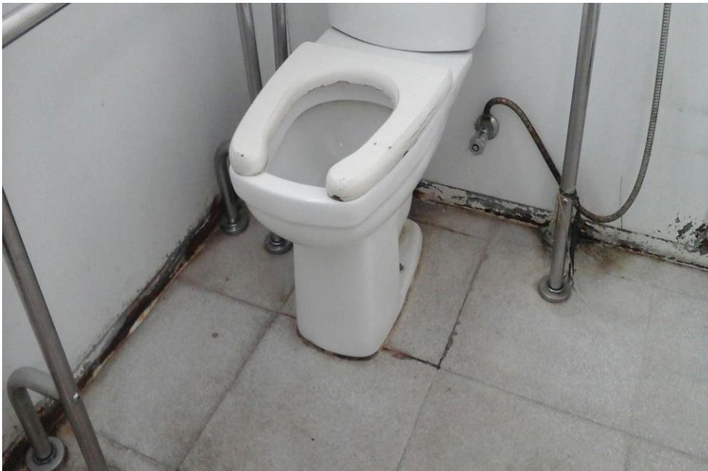
Rodapé enferrujado nos banheiros – CF Emydgio A. C.Filho
