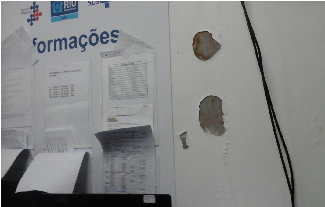
Parede malconservada devido a infiltrações – CMS Milton F. Magarão
