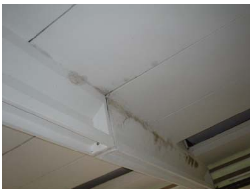
Figura 1 Infiltrações no teto do corredor (circulação interna) da unidade
