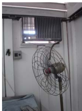
Figura 2 Carcaça de ar-condicionado vazia e ventilador fazendo a refrigeração do consultório
